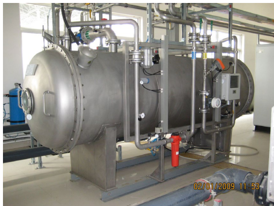
20kg/h臭氧发生器放电室
