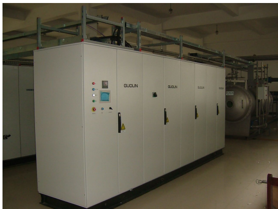
20kg/h臭氧发生器运行现场
